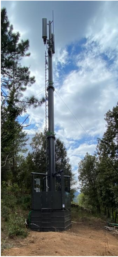
Pylône monotube de Bonifatu
