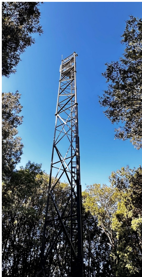
Pylône treillis de Guargale
