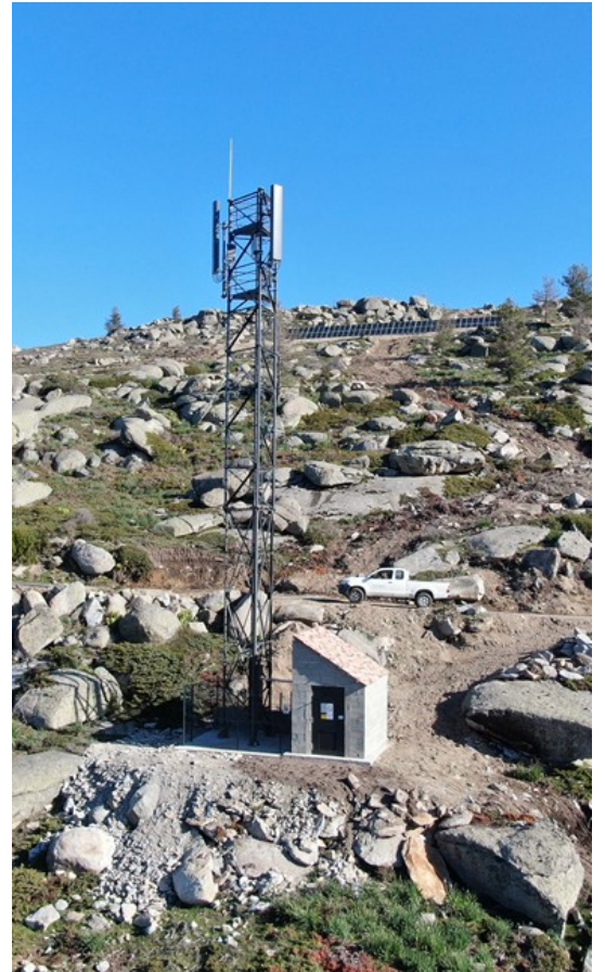
Pylône de Corti (Tavignanu) alimenté par panneaux solaires
