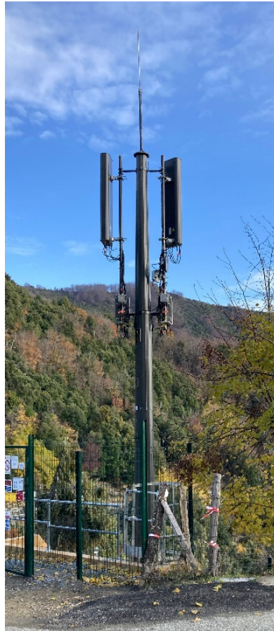
Pylône monotube de Bustanico
